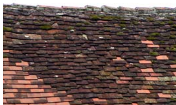
Toit en tuile plate Roziers-Saint-Georges
