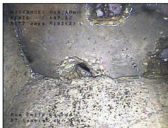
Photo 8 : Infiltration avec écoulement
