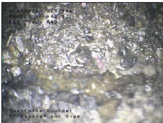
Photo 9 : Dégradation de surface
