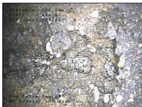
Photo 5 : Dégradation de surface
