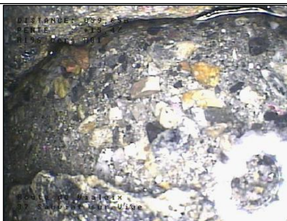
Photo 3 : Dégradation de surface
