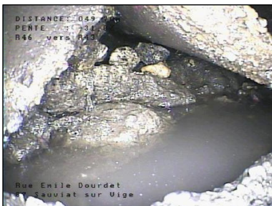
Photo 11 : Vide entre conduite de raccordement et canalisation
