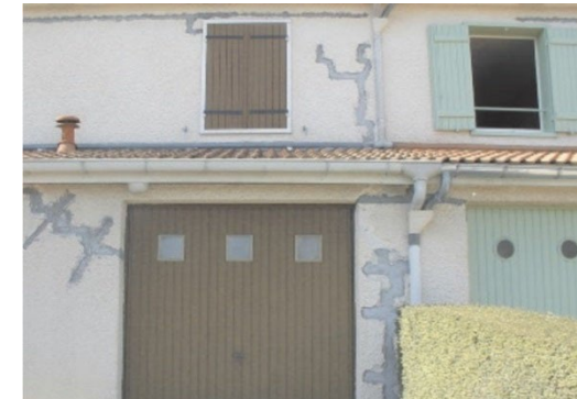
Une conséquence du retrait-gonflement des argiles : la fissuration de la structure des bâtiments
