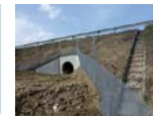
Passage petite faune de l'autoroute A7. Vue sur le dispositif installé côté plateforme de passage. Source : Vinci Autoroutes/Réseau ASF.
