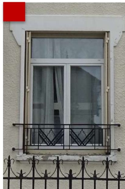
A éviter : menuiserie en PVC
