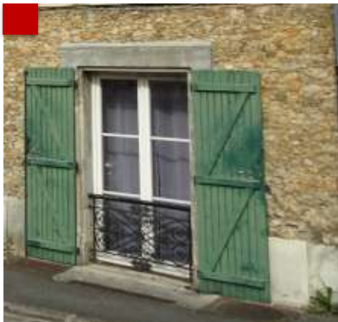
A éviter : volets à écharpe
