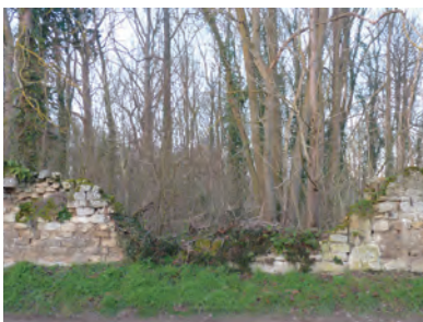
Un mur laissé en l'état après effondrement
