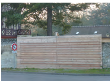
Une palissade bois assure temporairement le rôle de masque de la partie effondrée
