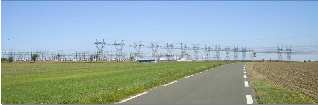
Figure 75 : Poste de transformation électrique, vu depuis la rue des blancs manteaux
