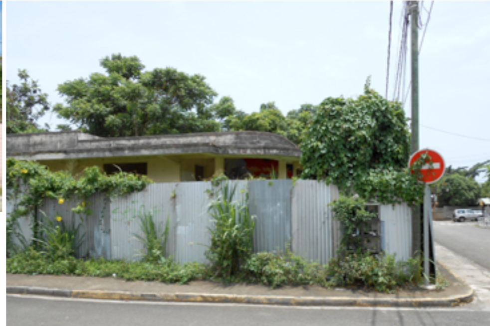
Dispensaire aujourd'hui : un bâtiment délaissé à mettre en valeur
