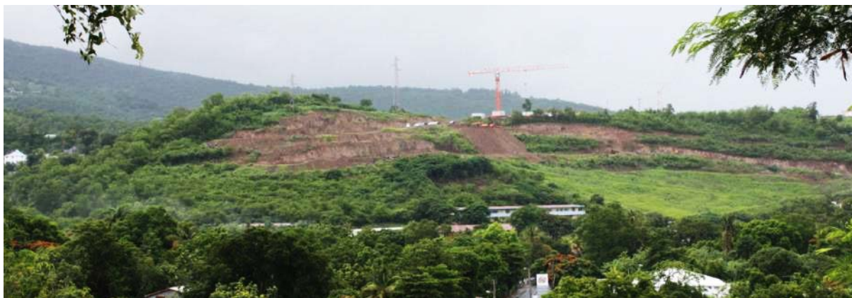
Figure 23 : Terrassements pour le lotissement à Morne-à-Jules (Source : Atlas Paysage) Le programme de logements réalisé comprend 200 logements environ (photosci+dessous des programmes Kachiman)
