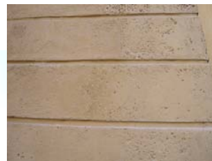
Motifs de joints creux dans l'enduit
