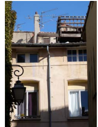
Terrasse disgracieuse posée sur la couverture.
