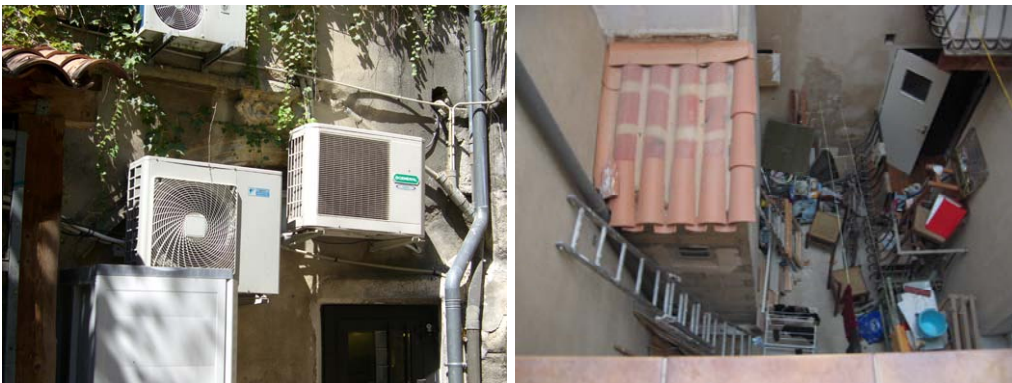
Photographies des cours et jardins, équipements techniques ci-dessus à gauche, stockage, édicule parasitaire et imperméabilisation des sols ci-dessus à droite, cliché V.W.
