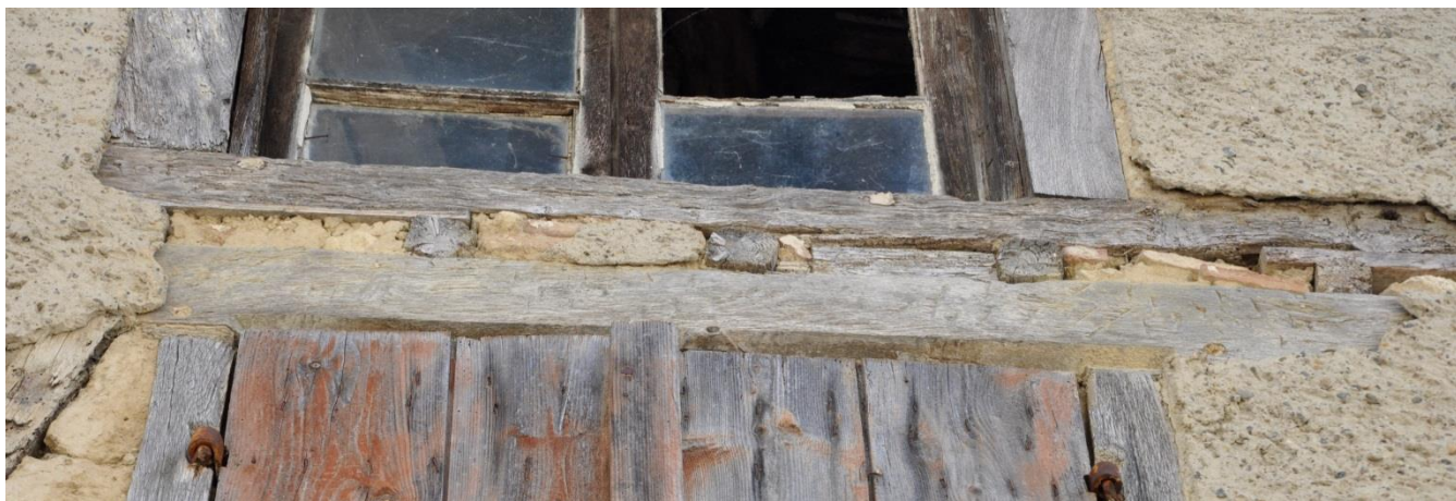
Vestiges de la croisée de la maison 35 rue Antichan : chanfrein et emplacement du meneau
