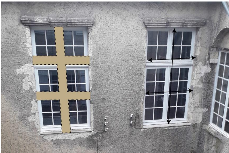
41 rue Nationale : les fenêtres du bâtiment central portent les traces de l'emplacement d'anciens croisillons et du meneau.
