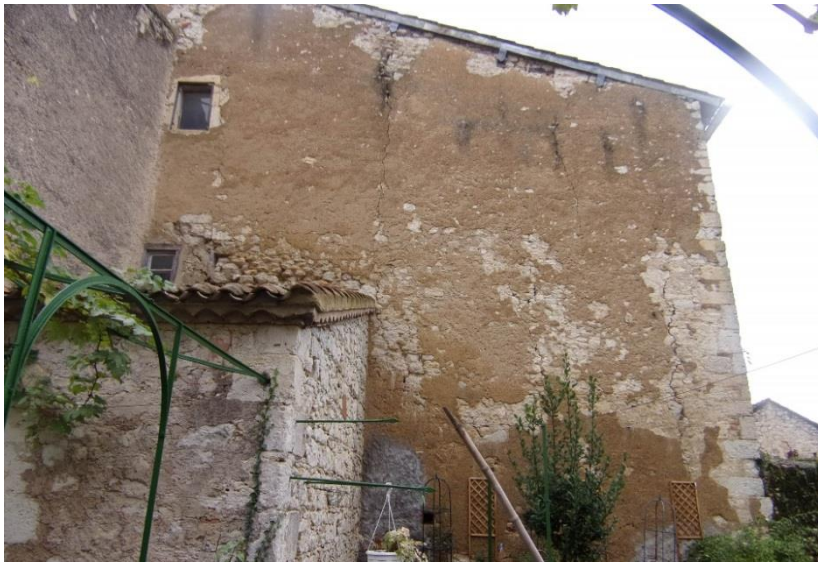
Façade en pierre enduite altérée, couleur du sable local.
