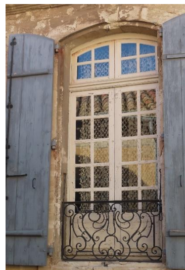
5, rue du Chapeau Rouge. Hôtel de Montal. Porte-fenêtre et menuiserie à petits bois.
