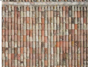
Tuile canal (pureau excessif)
