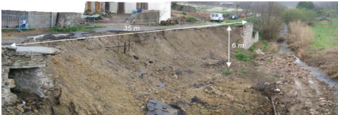
Eboulement constaté (BRGM le 4/4/2013)
